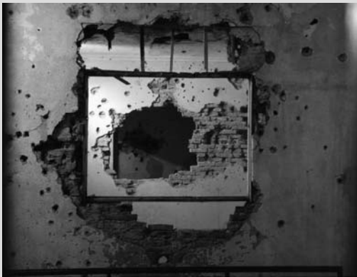
Estado en el que quedó el hueco principal situado en la fachada de la casa tras el ataque (Fuente: GANDOLFI; OTAVIANELLI, 2011)
