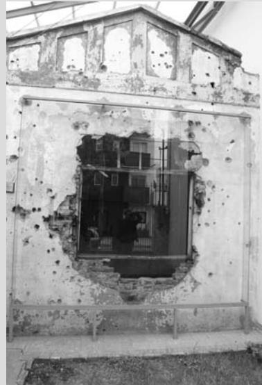
Fachada a la calle y acceso principal a la casa en la que pueden apreciarse los efectos del ataque, agujeros de metralla y desperfectos en el hueco de la ventana, musealizados mediante la superposición de un vidrio sobre estructura de acero galvanizado. (Fuente: MGCG, 2011)
