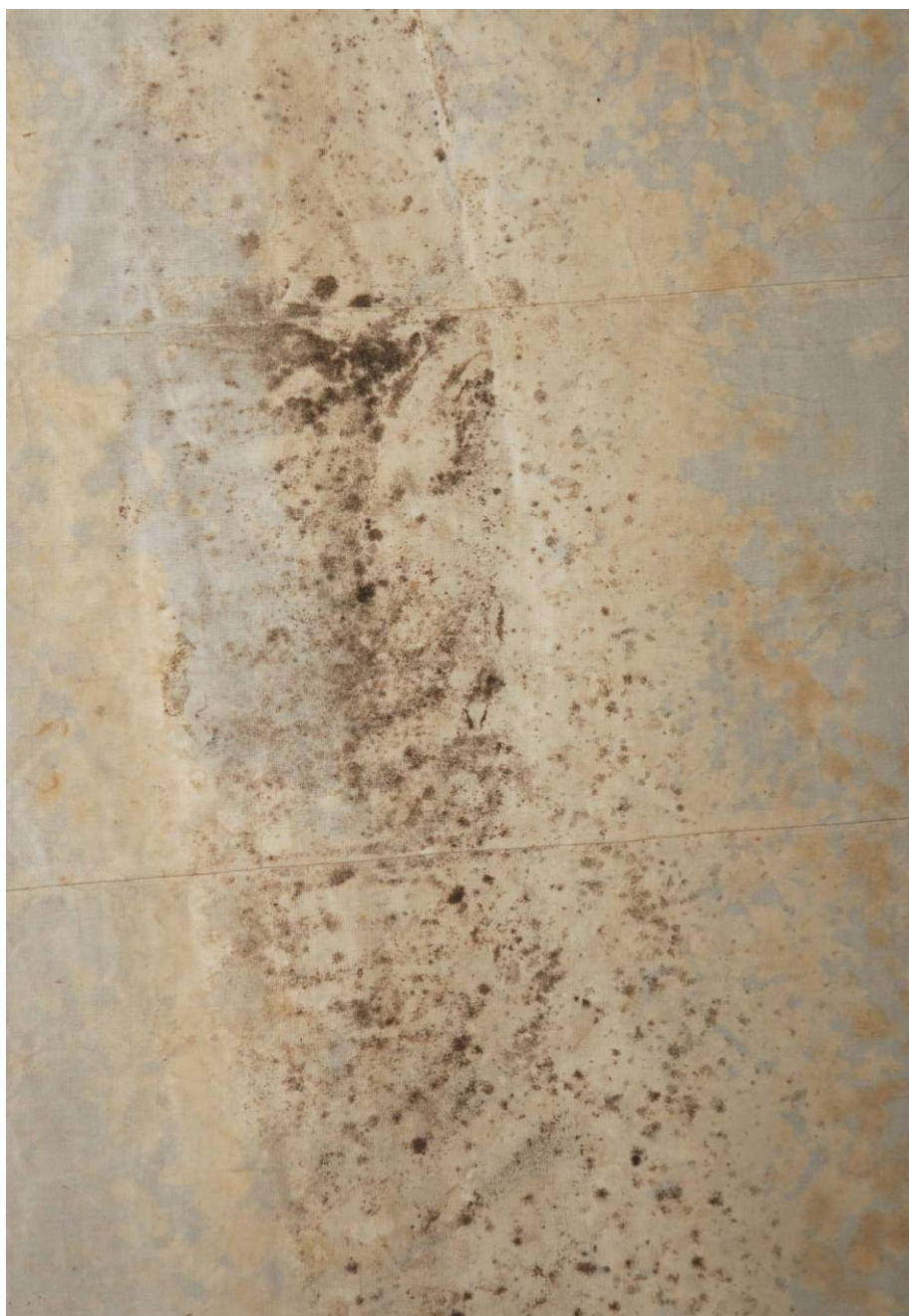
ALTERACIONES. INICIAL. DETALLE DE MARGEN IZQUIERDO. REVERSO DEL PLANO.
