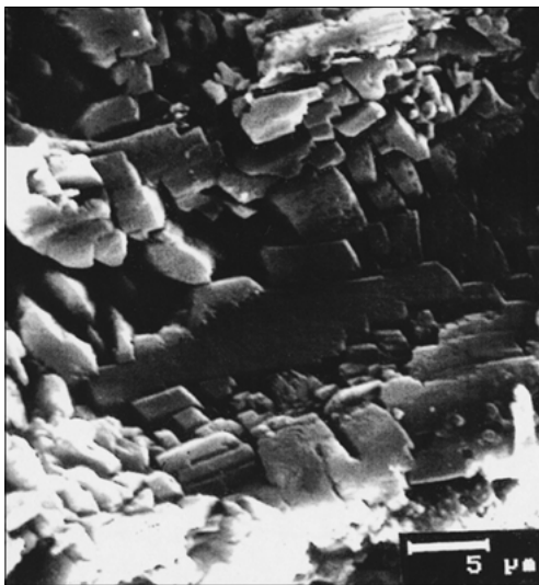
Yeso de alteración desarrollada en la superficie de un mortero de cal.
