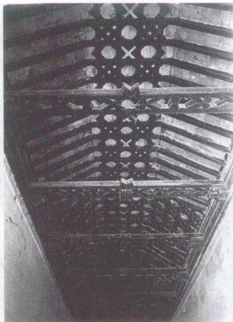
6.- Casa de Coullaut Valera, antigua de los Montiel (antes de su restauración). Artesonado
