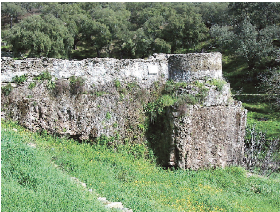
VISTA GENERAL DE UNO DE LOS MOLINOS DE CUBO EN BUEN ESTADO DE CONSERVACIÓN
