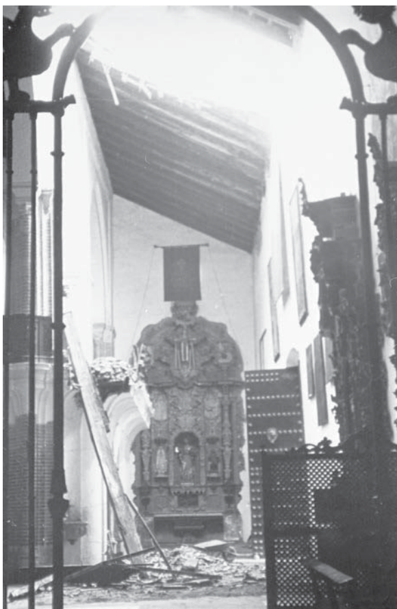
Lám. nº 9.- Hundimiento de la cubierta de la nave del Evangelio, con el retablo de Santa Apolonia al fondo. Al principio a la derecha se observan dos retablos de perfil, son el de San Pablo y el de la Virgen del Rosario, 1965.
