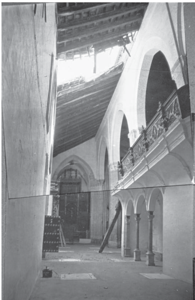
Lám. nº 1.- Hundimiento parcial de la cubierta de la nave del Evangelio en 1963.
