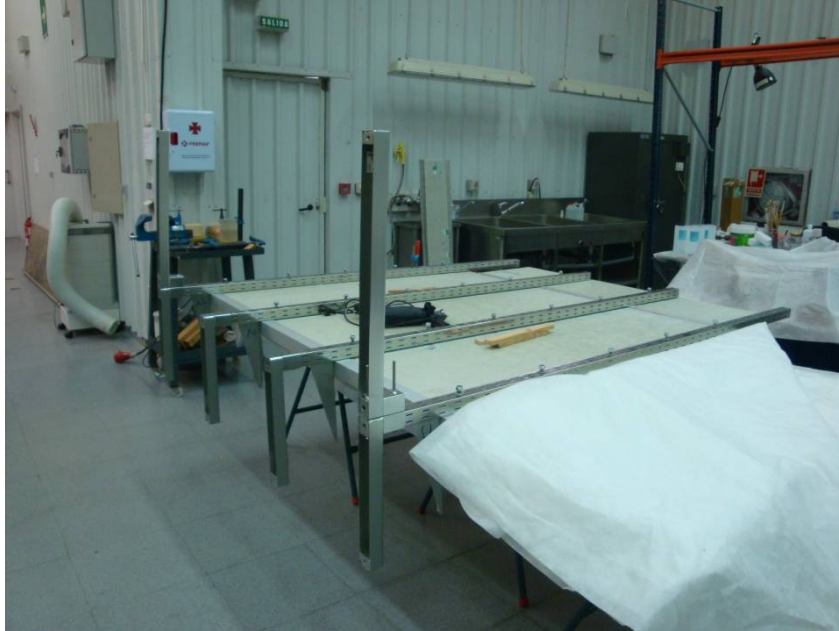
Preparación de la estructura de acero galvanizado con una plancha de AEROLAM F-BOARD.
