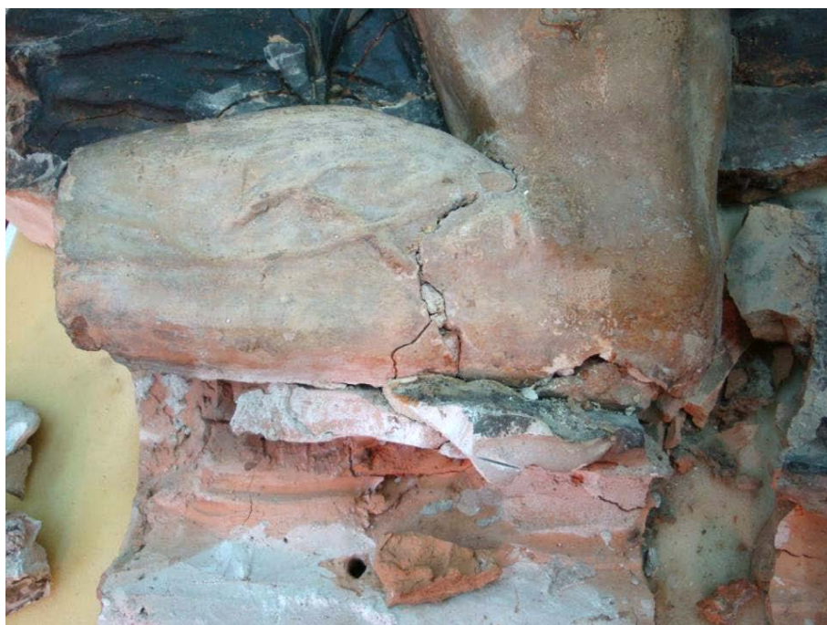
Depósitos superficiales, grietas, fragmentación, micro fisuras.
