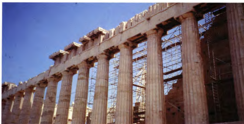
5_Acrópolis de Atenas. Efectos de la contaminación atmosférica sobre el Partenón.
