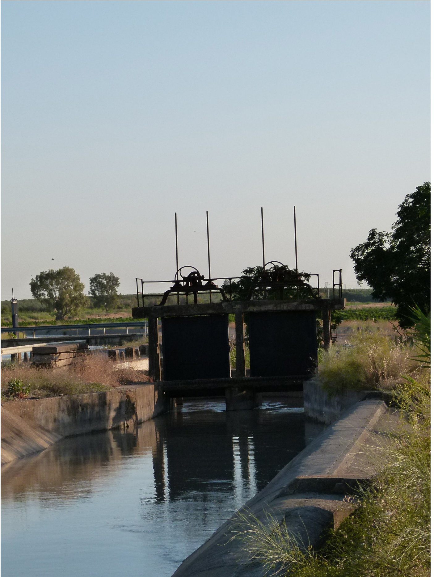
Infraestructuras hidráulicas sobre el Canal del Valle inferior del Guadalquivir
