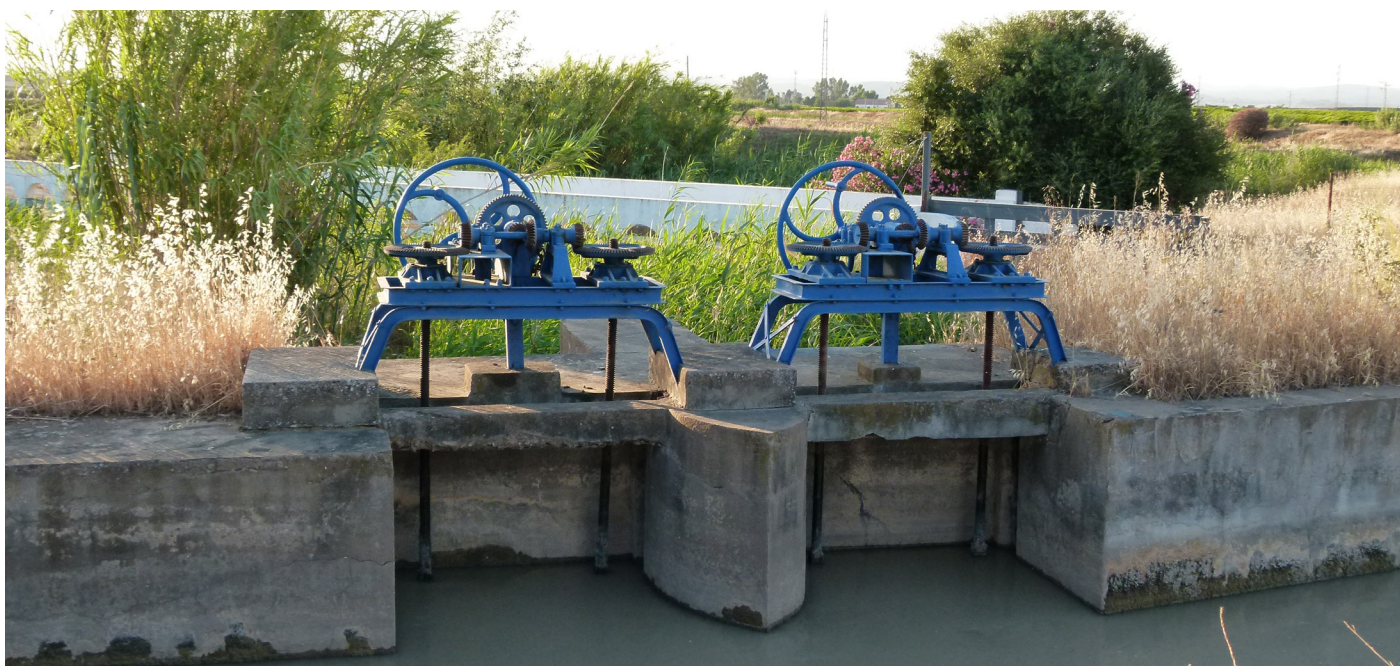
Infraestructuras de regadío en el Canal del Valle inferior del Guadalquivir
