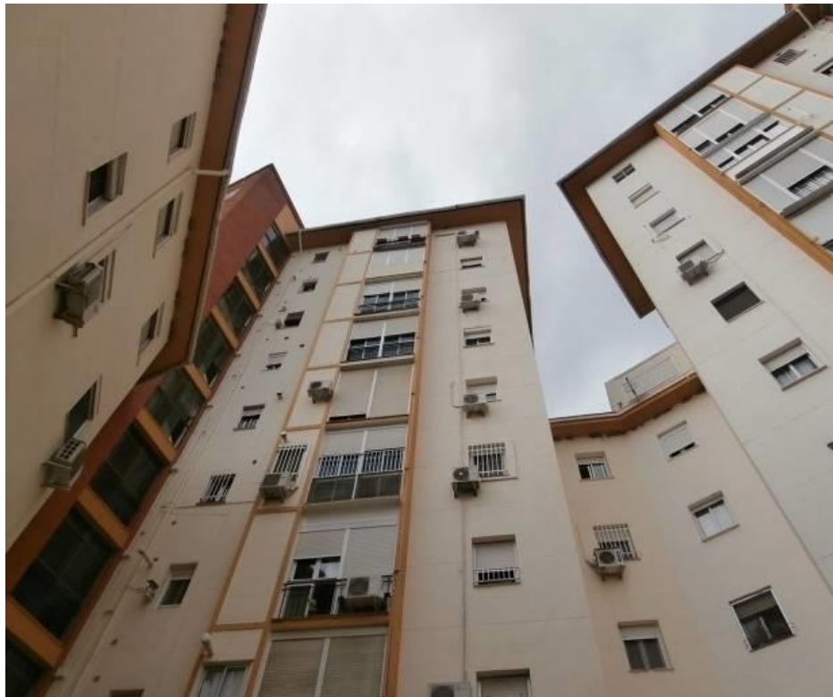
Fig. 51 Vistas de la fachada y el voladizo donde se aprecia la canalización para aguas pluviales.
