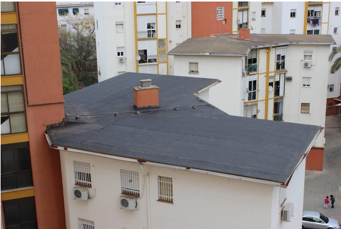
Fig. 54 Fotografía del estado actual de la cubierta de otros bloques.
