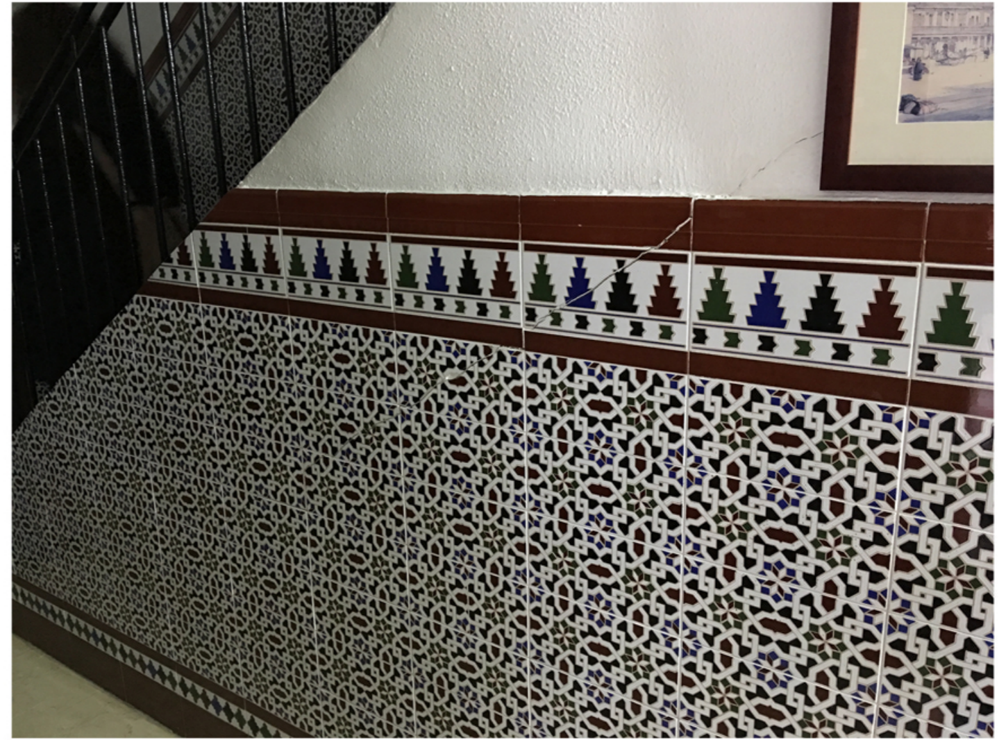
Imagen de lesión: 3.02 D Fisura (1)
