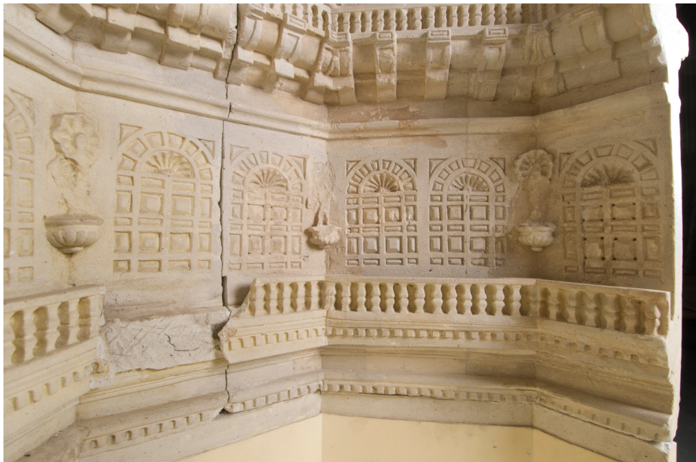
Grieta que divide en dos mitades la parte baja de la maqueta.
