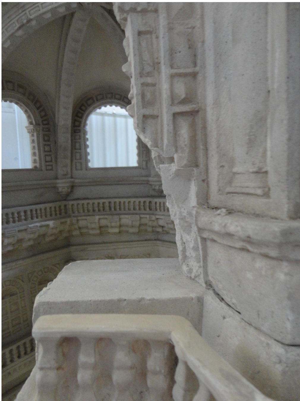
Gran pérdida de volumen en la jamba de un arco situado en la zona que da acceso al interior.
