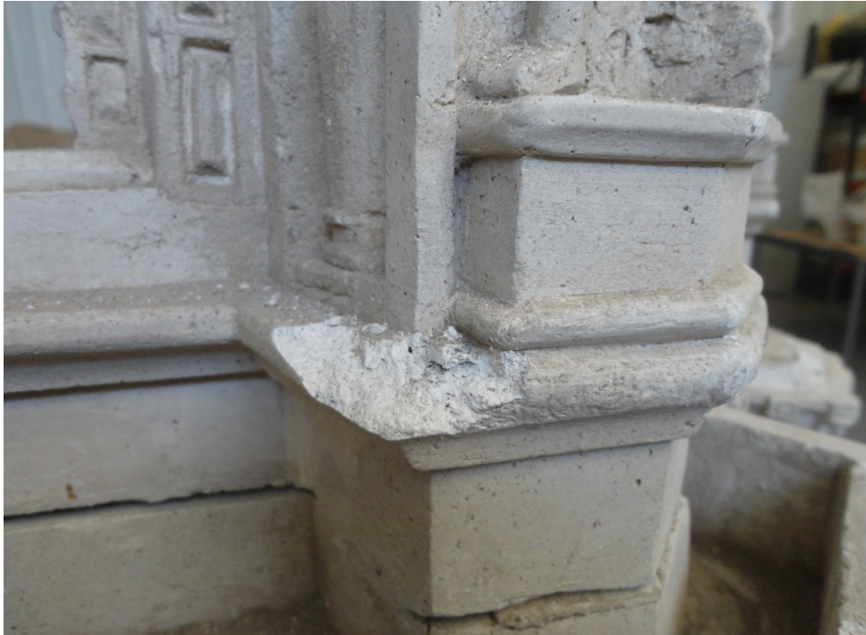
Pérdida de volumen en una cornisa externa de la pieza.
