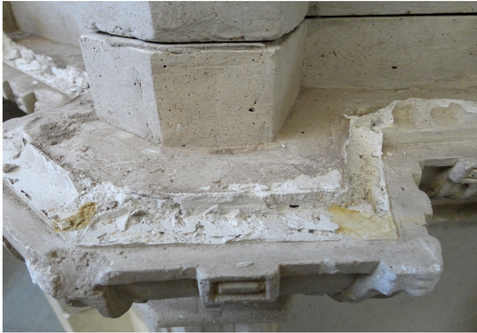
Detalle de la pérdida de la balaustrada. Sede donde se hallaba ubicada. Fig.12.
