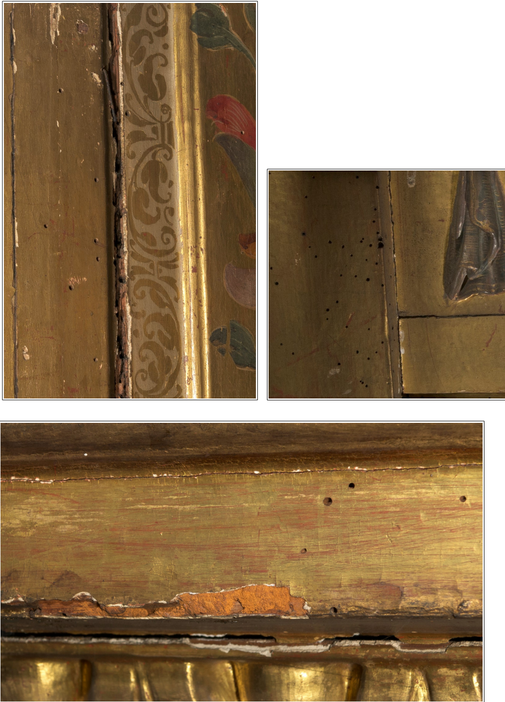
DETERIORO ORIGINADO POR INSECTOS XILÓFAGOS (DETALLES)
