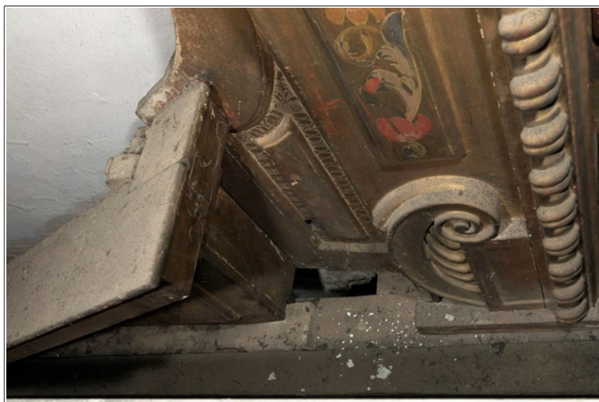
SUCIEDAD Y DEPÓSITOS SUPERFICIALES (DETALLES)
