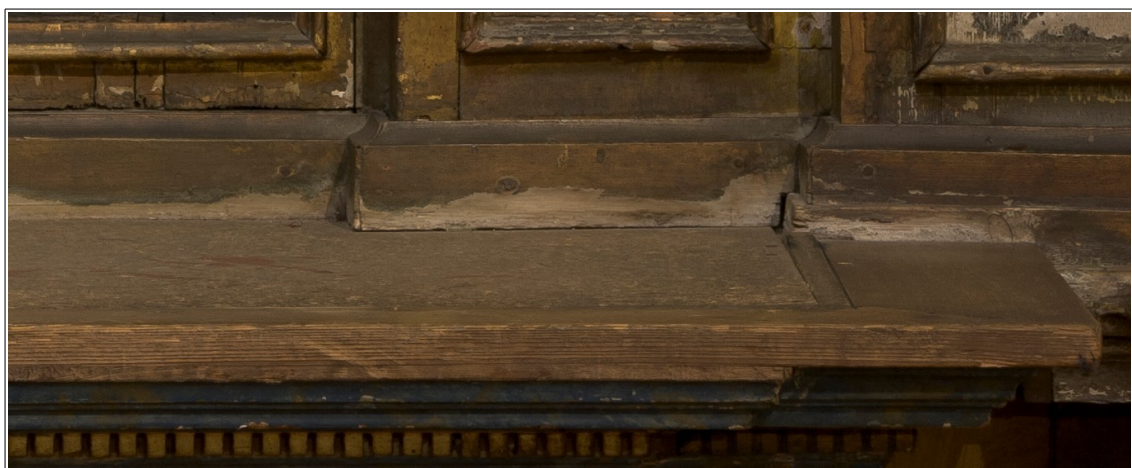
Intervenciones anteriores: piezas añadidas (aglomerado y listón en madera de pino)
