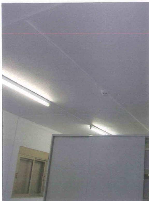
SISTEMA DE ILUMINACIÓN FLUORESCENTE.
