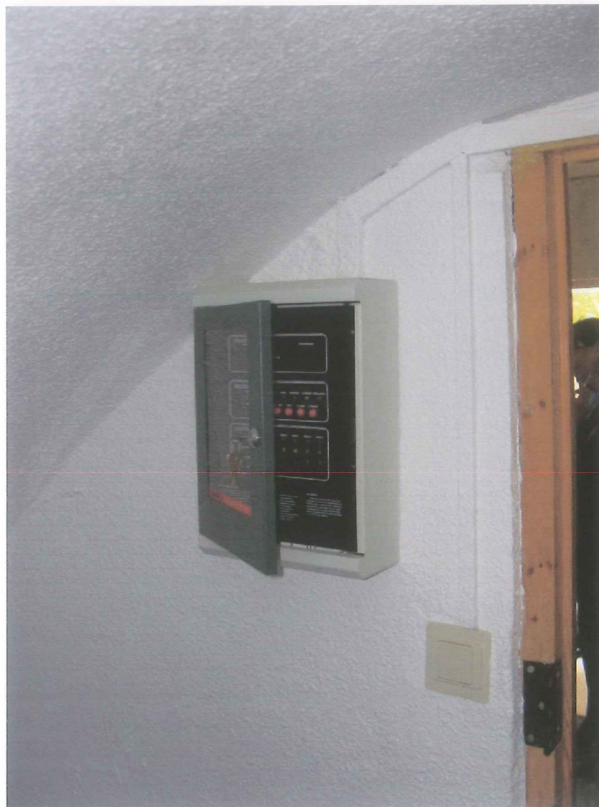
SISTEMA CONTRA INCENDIOS.
