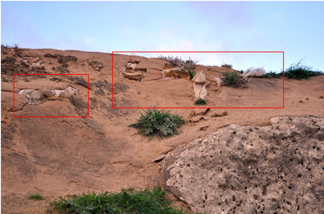
Detalles de los desperfectos de la cubierta de Menga y vista de la lamina plástica de cubrición.
