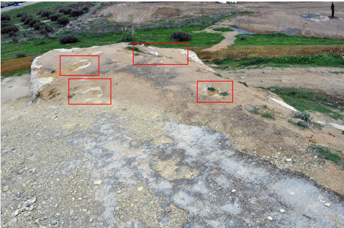
Detalles de los desperfectos de la cubierta de Menga
