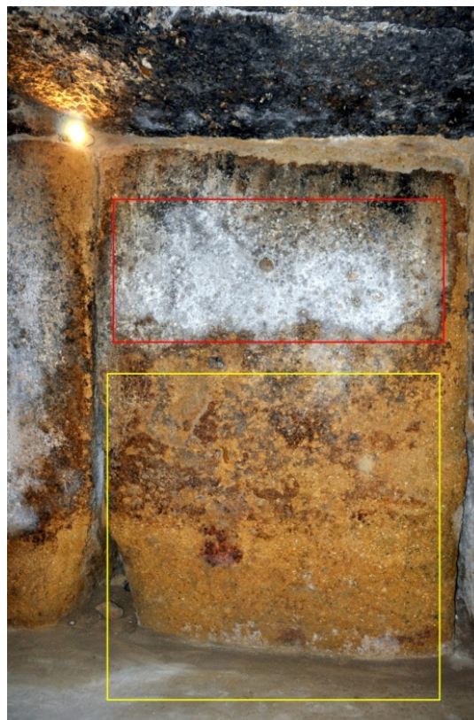
Detalle de la presencia de sales en la roca del ortostatos en rojo y detalle de la filtración ascendente de agua en amarillo.
