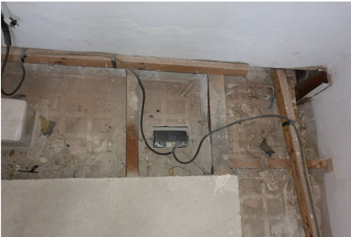
Foto nº 10. Vista del sistema de iluminación primitivo (Foto Raniero Baglioni).
