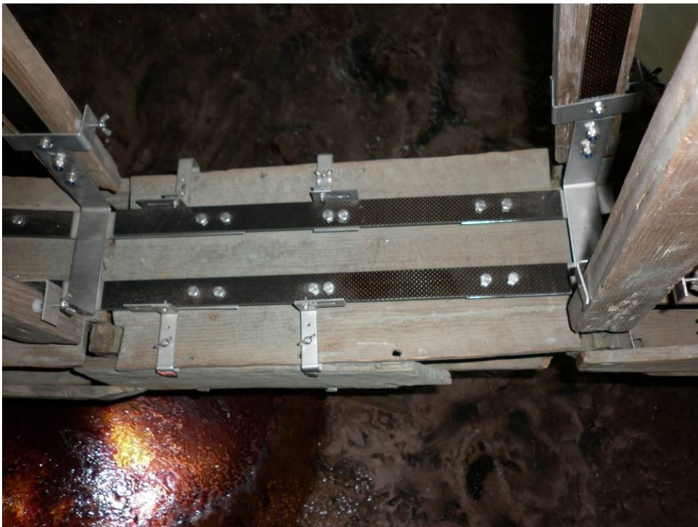
Foto nº 4 Vista en particular de oxidación de la estructura de acero (Foto Raniero Baglioni).
