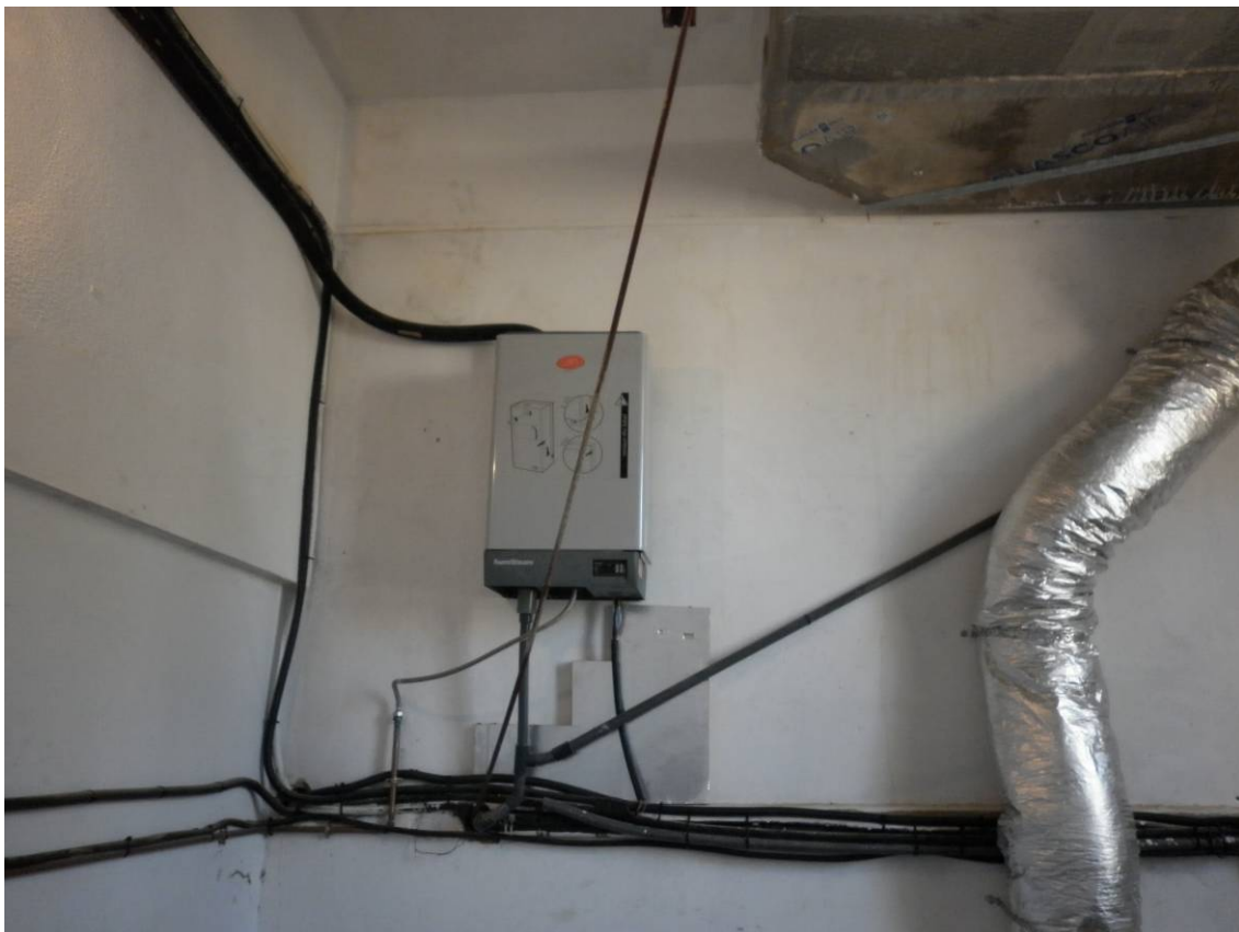
Foto nº 7. Vista del sistema de humectación (Foto Raniero Baglioni).
