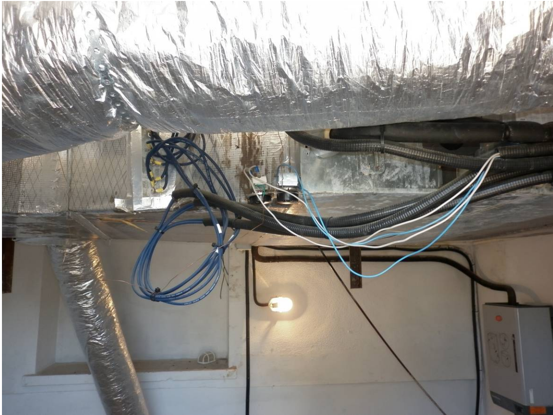
Foto nº 11. Vista del sistema de control y programación de la maquinaria (Foto Raniero Baglioni).
