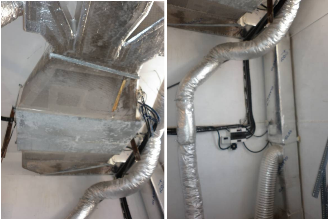
Fotos nº 5-6. Vista del antiguo sistema de climatización no operativo (Foto Raniero Baglioni).
