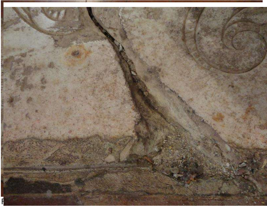
Fig.2.16. Detalle de la gran grieta que divide la pieza llena de depósitos.
