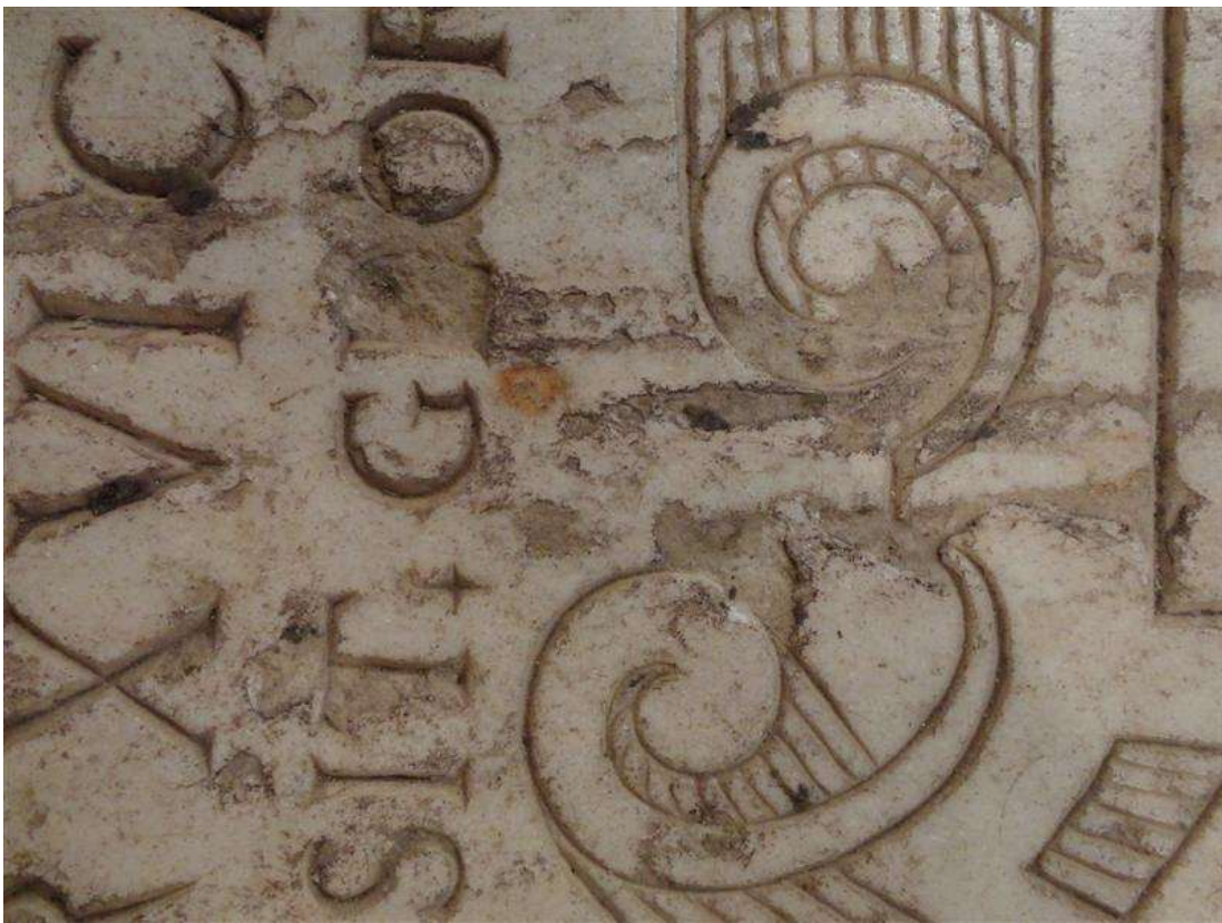
Fig.2.19. En esta fotografía se aprecia otra zona del escudo con alteraciones por pérdida de material, oxidación y erosión.
