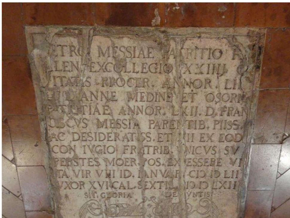
Fig.2.14. Alteración de la superficie en forma de acanaladuras que recorren la lápida.
