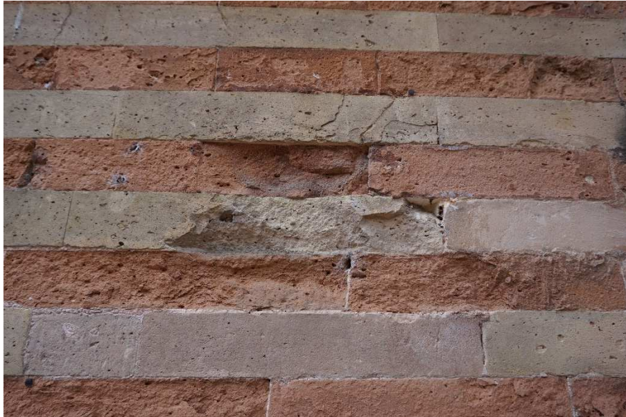
Alteraciones en ladrillos.
