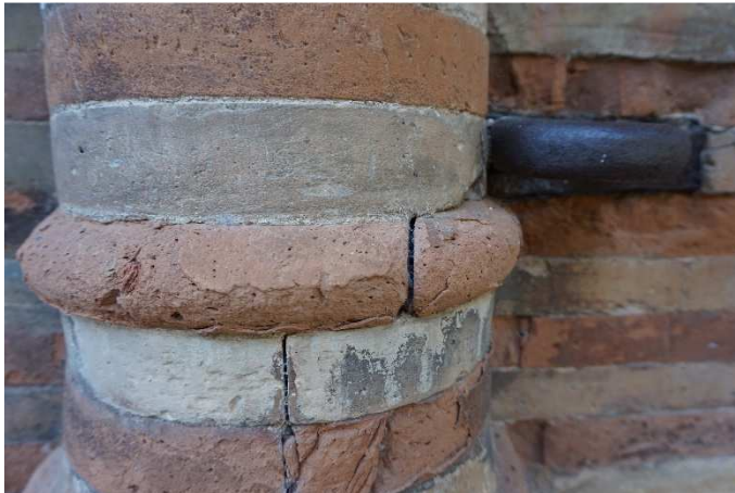
Grietas por oxidación
