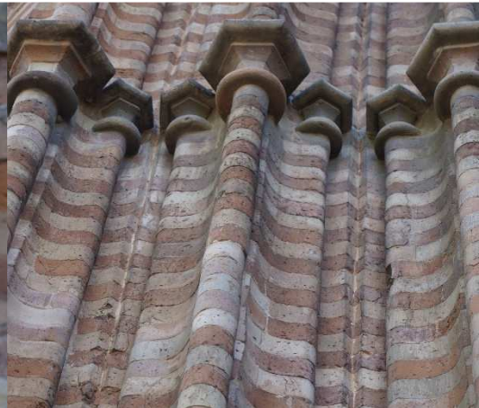
Grietas en baquetones.
