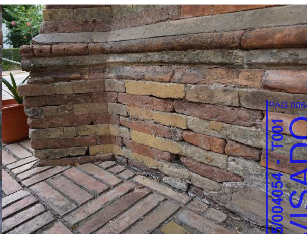
Pérdida de morteros.
