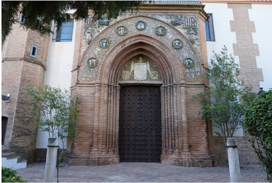
Humedades de capilaridad en portada.
