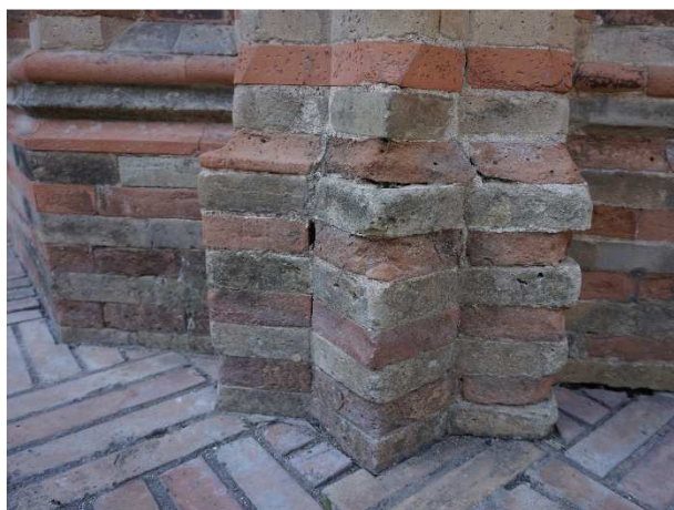
Erosión del ladrillo.
