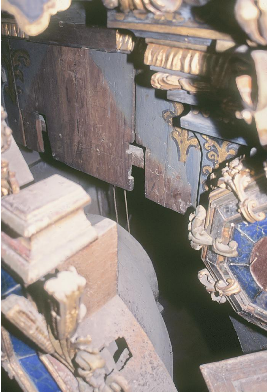
Retablo Mayor, detalle desajustes de piezas y roturas y acumulaciones de polvo
