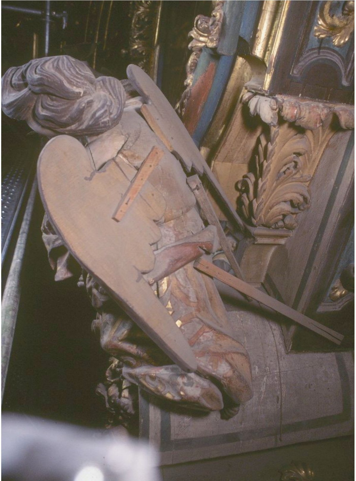
Retablo Mayor: detalle de la precariedad del sistema de sujeción de los ángeles
