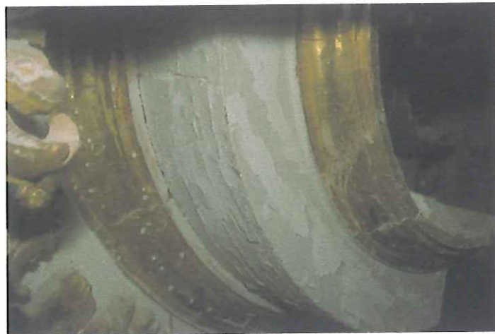
Moldura mixtilínea del ático. Detalle policromía blanca. Levantamientos y pérdidas.
