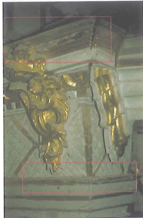
Entablamento 1º cuerpo. Falta de adhesión y pérdidas del dorado.
