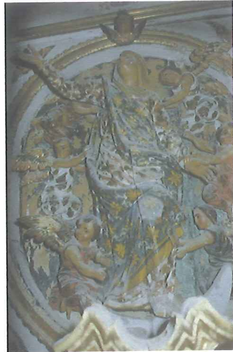
Relieve de la Asunción. Falta de adhesión y pérdidas generalizadas del estrato de repolicromía.
