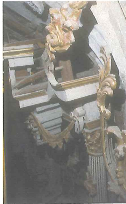
Ático . Desplazamiento del remate.
