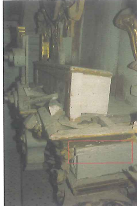
Entablamento 2º cuerpo. Movilidad de piezas y deficiente sistema de fijación de apliques y molduras. Detalle ataque de insectos xilófagos sobre el soporte.
