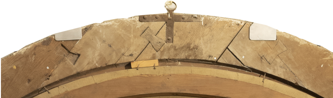
SEPARACIÓN Y ROTURA DE PIEZAS, PÉRDIDA DE COLA DE MILANO.
