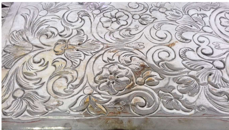
Productos de corrosión. Fuente: IAPH/Constanza Rodríguez Segovia
