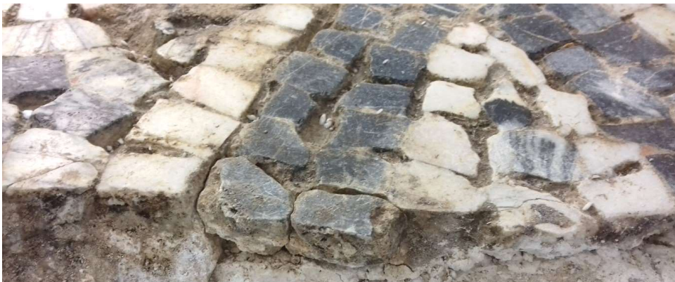
Teselas fracturadas y con pérdida de materia
