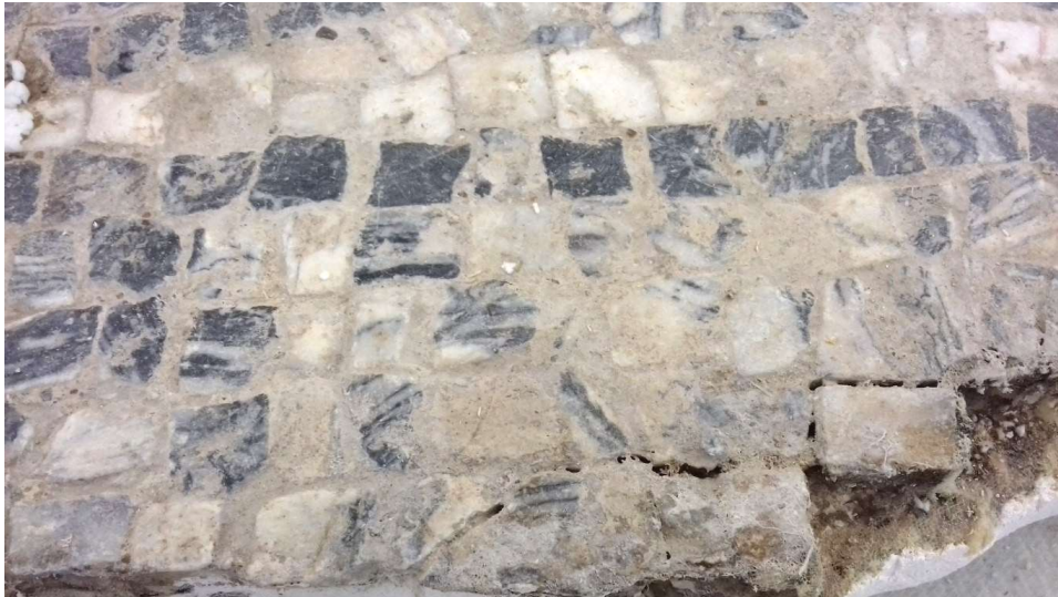
Suciedad y costras de carbonato cálcico
