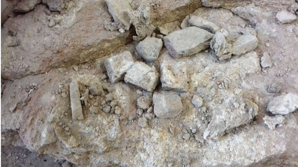
Teselas desprendidas del mortero y totalmente desubicadas
