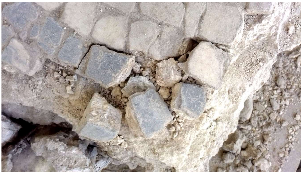
Teselas desprendidas del mortero
