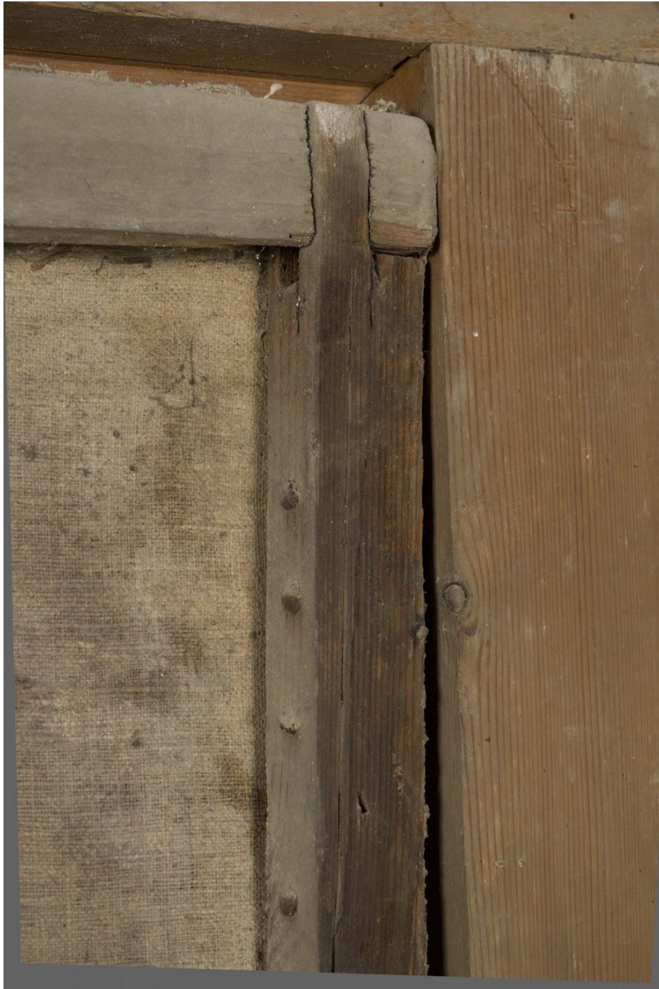
ESTADO DE CONSERVACIÓN DEL BASTIDOR. UNIÓN DE GRIETAS CON CLAVOS ACTUALMENTE OXIDADOS Y SUCIEDAD SUPERFICIAL.
