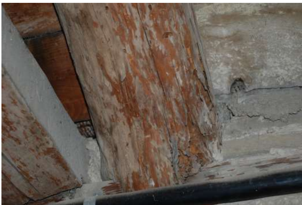
Fig 10. Inicio de pudrición en el contacto de la viga con el muro de obra.
