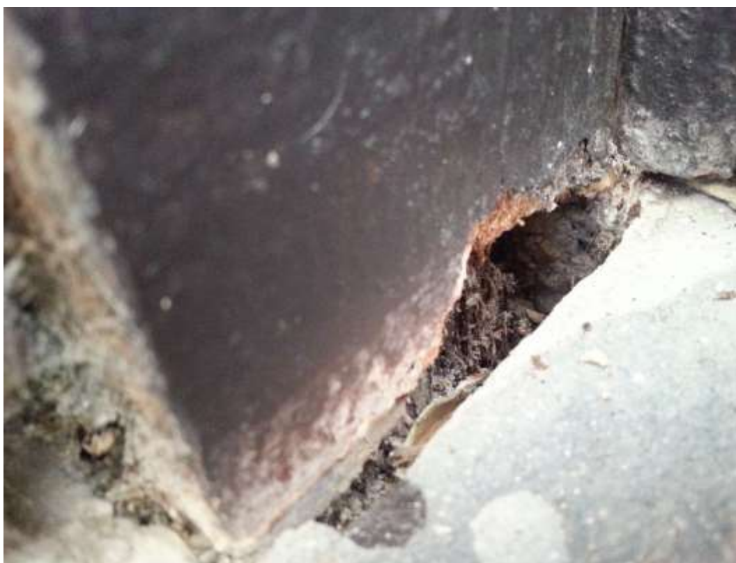
Fig 5. Pudrición parda de la base del marco de la puerta.
