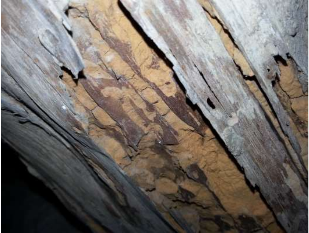
Fig 8. Galerías de cerambícidos en una de las vigas de la cubierta.
