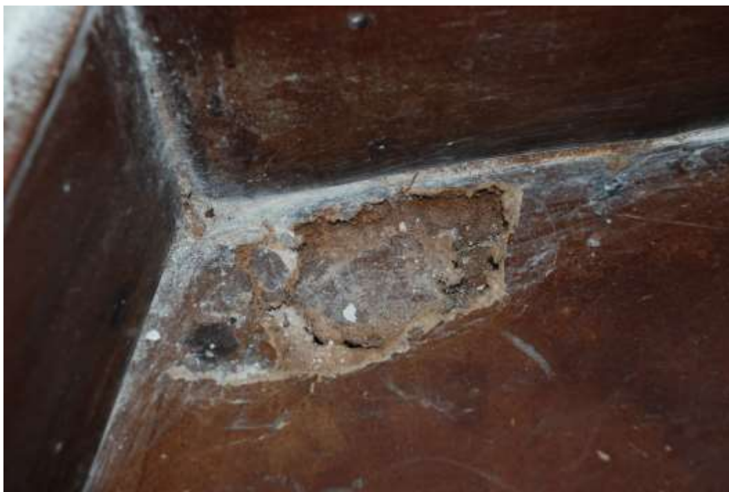
Fig 4. Daños en entarimado y rastreles que lo sustentan.
