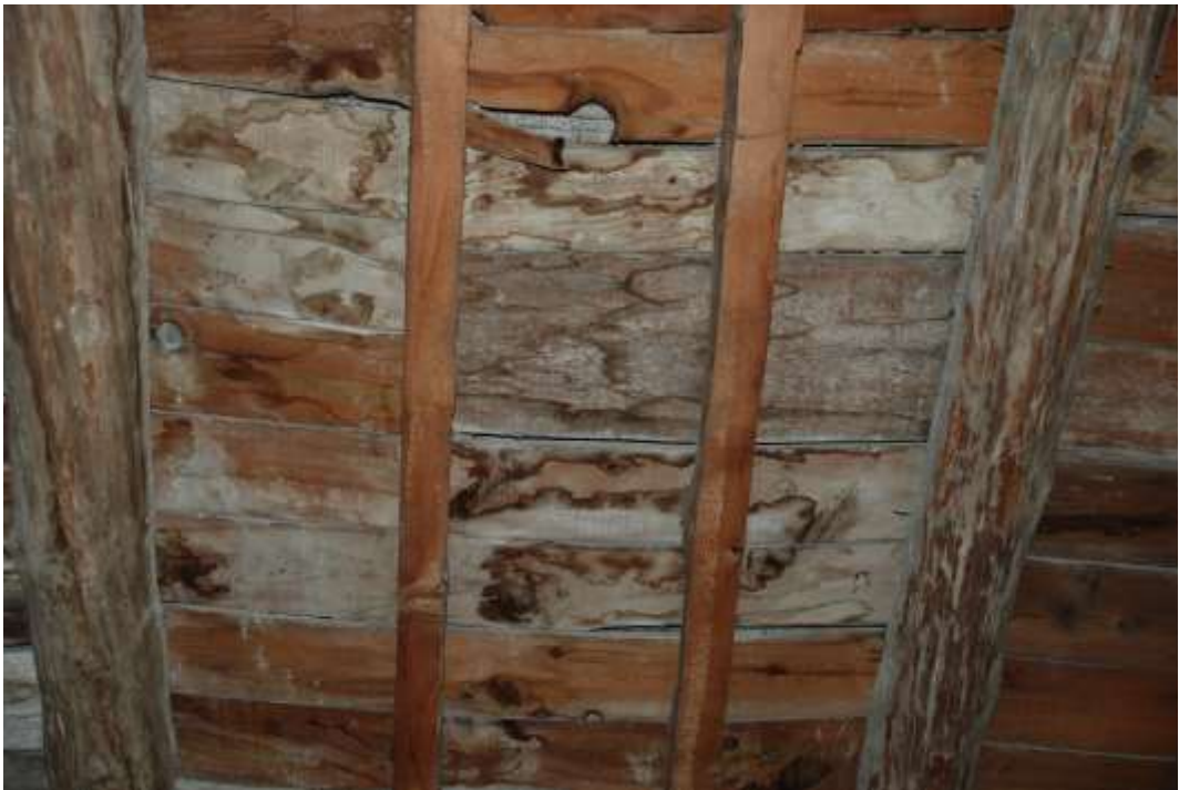
Fig 9. Pudrición blanca y parda por problemas de filtración de agua.
