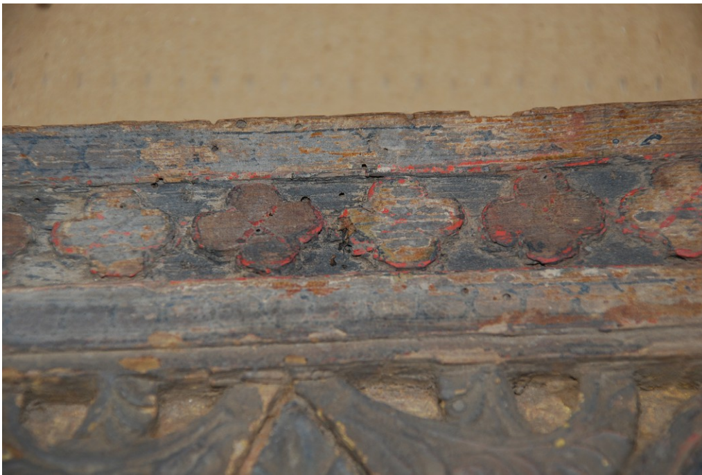
Fig. 22. MC-07. Viga. Orificios de salida y galerías de anóbidos.
