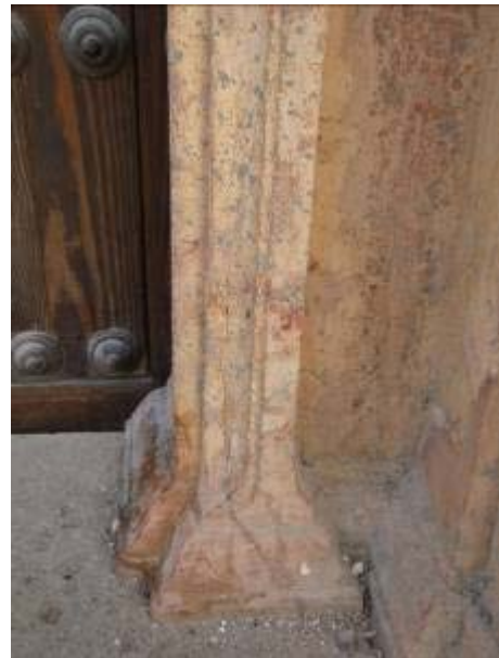
Fig. 8. Agresiones antrópicas de antiguas intervenciones: Mortero de cemento sobre mármol de las jambas
